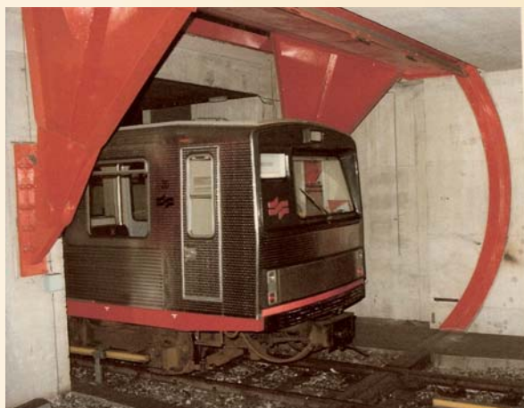
Sluitdeur van het spoor van een metrostation (Amsterdam)
